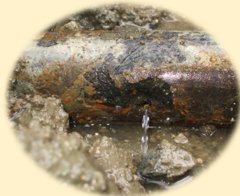
埋設下水配管の腐食による漏水
