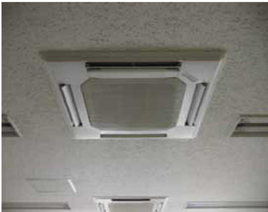
(3) 省エネ型エアコンへの更新
