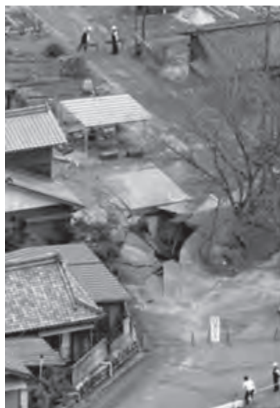
写真2 道路陥没の他、家6軒が傾いた被害の様子 16)
