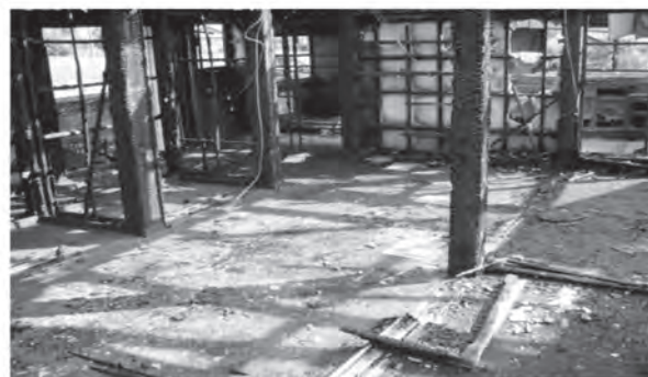
罹災発生現場(事例)
