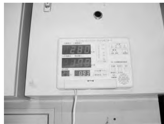
写真2 デマンドコントローラーの事例
