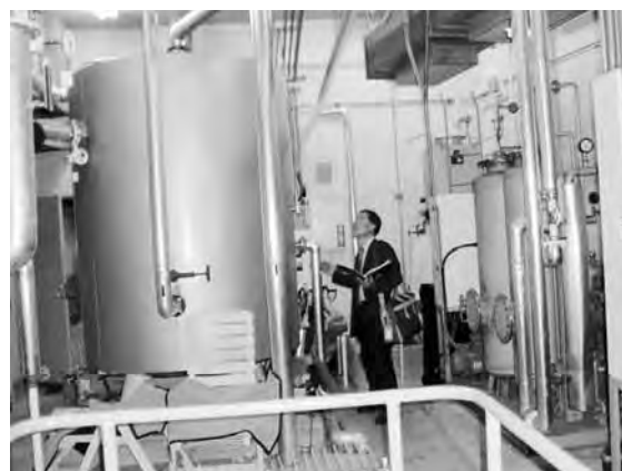
写真1 現地相談の事例（温浴用給湯設備）
