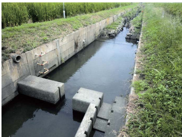
図 8 堰板が設置されていない現在の E3(小型堰・三面) 写真奥は E4(空石積)(平成 29 年 9 月 23 日)
