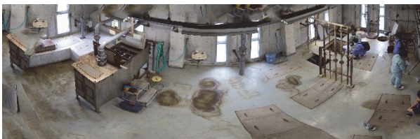
写真 2 処理施設内のパノラマ写真(泊地区) (写真左から流量調整槽・中程の右に曝気槽と沈殿槽、 右奥に消毒放流槽が位置する)
